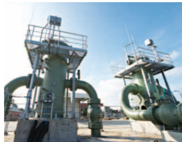
Mit einem Investitionsvolumen von rund 50 Millionen Euro zählt der Verdichter Ochtrup zu den größeren Ausbaumaßnahmen.
